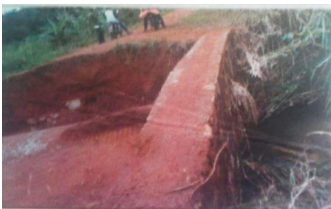
Photo 6. ouvrage endommagé après trois jours de pluies dans la région de Man. Plus de 15 villages sont coupés de la ville. Cliché, Droh h, 2016.
