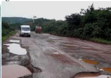
Photo 7. La côtière (Grand-Lahou - San Pedro) fortement dégradée avec des nids d'éléphants constitue un véritable chemin de croix pour les usagers. Cliché : Kouassi F, 2016
