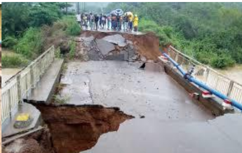
Photo 9. Route de San-Pedro-Abidjan par Gagnoa coupée où le bitume s'est affaissé après une journée de pluie. Cliché : Kouassi, 2017
