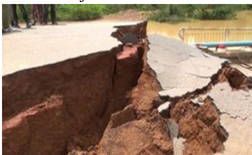
Photo 8. Effondrement du pont du "Corridor de Béréby" suite aux abondantes pluies dans la région de San Pedro. Cliché : Kouassi, 2017
